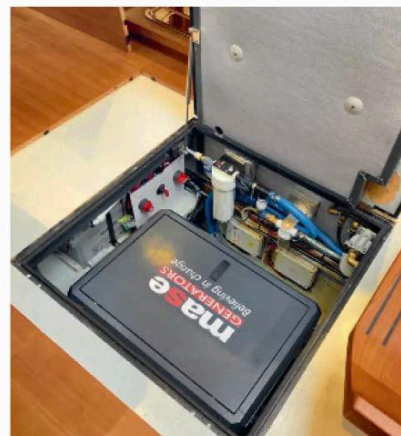
Unter dem erhöhten Salonboden findet die Technik ihren Platz, auch der Generator
