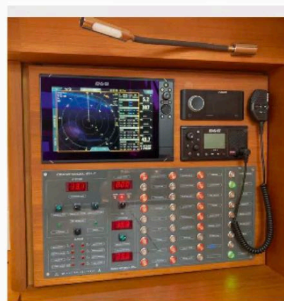
Unter Kontrolle. In der Navigation laufen alle Informationen und Steuerungen zusammen
