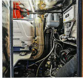
Sauber: Den Einbaumotor und Generator legt eine große Klappe unter dem Niedergang frei
